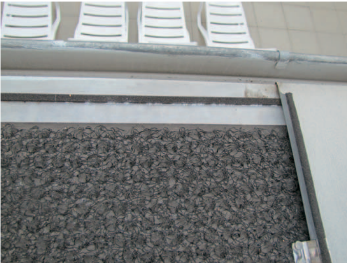
Abb. 6: Zeigt diffusionsoffene Unterdeckung mit Wirrfasergewebe. Zwischen Rin- neneinhang und Stehfalzeindeckung wurde hier mittels Schaumstoffband abgedichtet.
