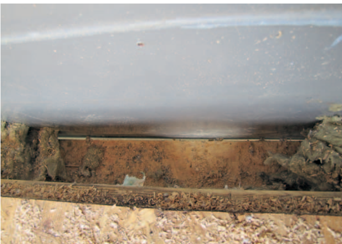
Abb. 3: Anschlussfuge, hier an Fassadenteil des Hallenbades nicht abgedichtet oder abgeklebt, Randfuge nur mit etwas Mineralwolle verfüllt.
