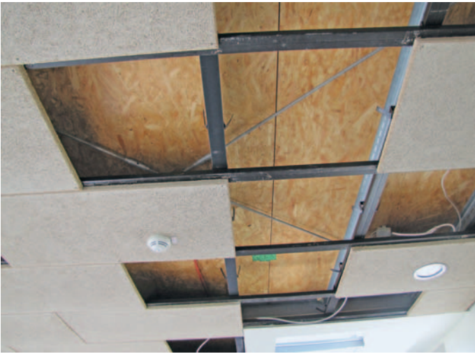
Abb. 2: Untersicht der Dachfläche mit Elementstoß, sowohl Folie wie auch OSB-Platte unverklebt.
