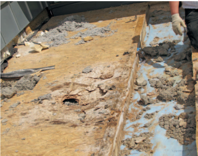
Abb. 5: Stark befallene kreisflächenförmige Schadstelle, weit entfernt vom Ele- mentstoß.
