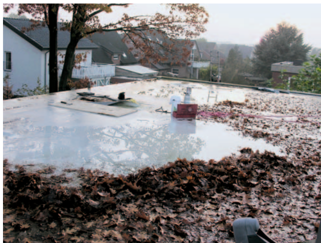
Abb. 2: Geschädigter Dachflächenbereich mit Laubbelag und Pfützenbildung im Vorfeld des Ortstermins zum Teil freigelegt.
