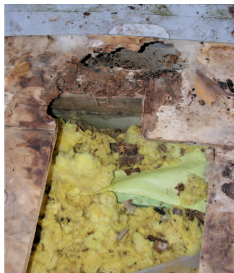
Abb. 3: Partiiell stark verrottete BFU-Platte im geschädigten Bereich nach Aufschneiden der Dachfolie.
