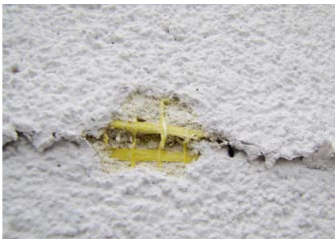
Abb. 6: Bei einer Stauchung im Fugenbereich knickt das starre Gewebe aus.
