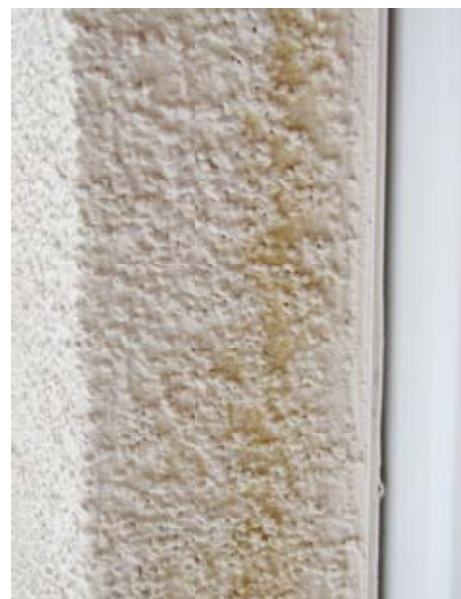
Abb. 5: Durch Anquellen der Stirnseiten der Weichfaserplatten löst sich die Anputzleiste vom Blendrahmen des Fensters.
