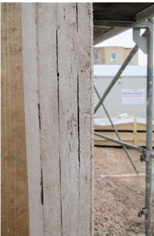
Abb. 4: Trotz Grundierung beginnen die Platten an der Baustelle bereits zu delaminieren.
