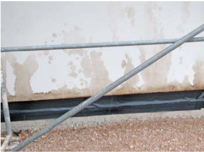
Abb. 3: Niederschlagsfeuchte sammelt sich im Sockelprofil und wird über die Stirnseiten der Holzweichfaserplatten wie ein Docht aufgesogen.
